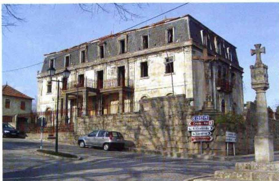
Vista de conjunto da "Casa do Passal" no estado em que actualmente se encontra. Note-se o completo desguarnecimento dos vãos
