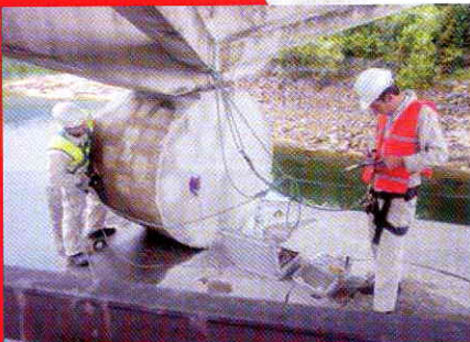
Fig. 1 - Medição da intensidade de corrosão de armaduras num apoio de uma ponte de betão.
