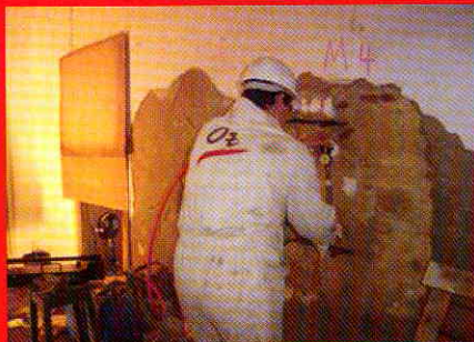
Fig. 2 - Ensaio de macacos planos para caracterização das propriedades resistentes duma parede de alvenaria.
