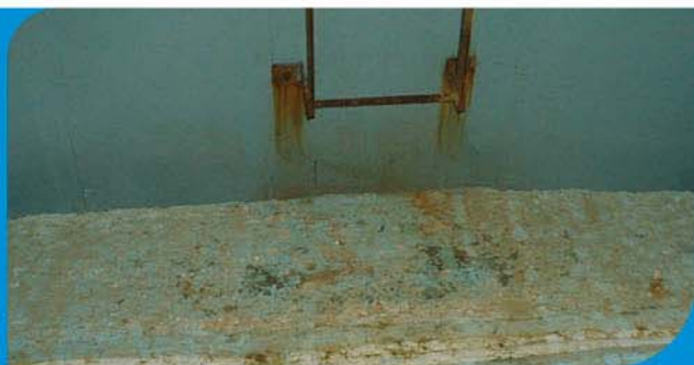
↓ ACUMULAÇÃO DE DEPÓSITOS NO FUNDO DE UM RESERVATÓRIO
