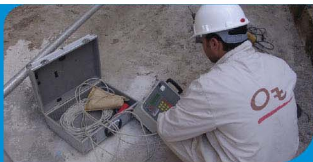
↓ AVALIAÇÃO DA INTENSIDADE DE CORROSÃO DAS ARMADURAS ATRAVÉS DA TÉCNICA DA RESISTÊNCIA DE POLARIZAÇÃO
