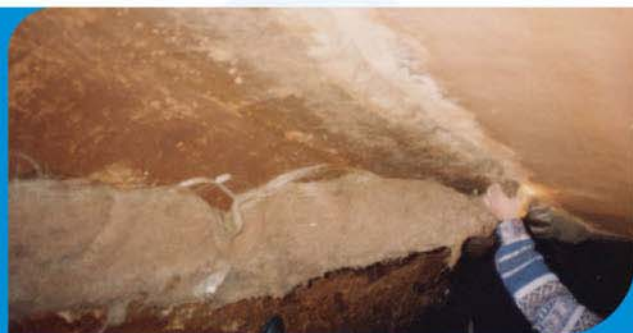
↓ RAÍZES DE GRANDES DIMENSÕES NO INTERIOR DE UMA CONDUTA
