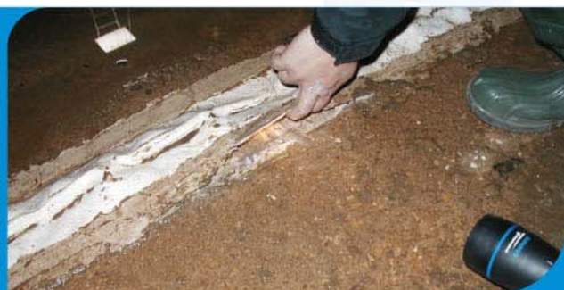
↓ DEGRADAÇÃO DA JUNTA DE ESTANQUICIDADE DE UMA LAJE DE FUNDO
