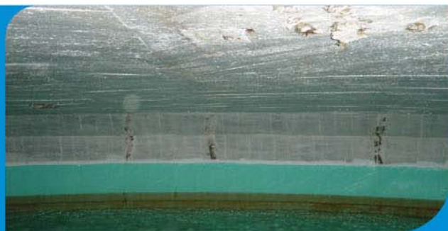
↓ CORROSÃO DAS ARMADURAS NA FACE INFERIOR DE UMA LAJE DE COBERTURA
