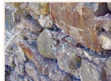
Desagregação das argamassas de ligação.
