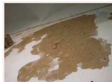
Desintegração de um reboco em resultado da cristalização salina.
