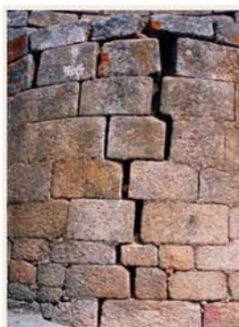
Juntas abertas em resultado de deformações estruturais.
