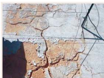
Fissuração de um reboco agravada pela acção da água incidente ou de escorrimento.
