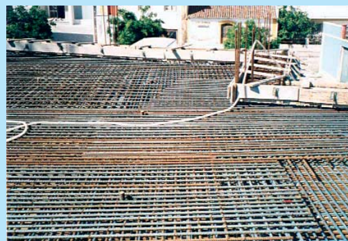
Foto 6: Mau dimensionamento. Excesso de armadura.
