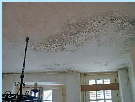
Foto 1: Infiltração de humidade. Deficiente pormenorização das ligações e remates da tela de impermeabilização subjacente.
