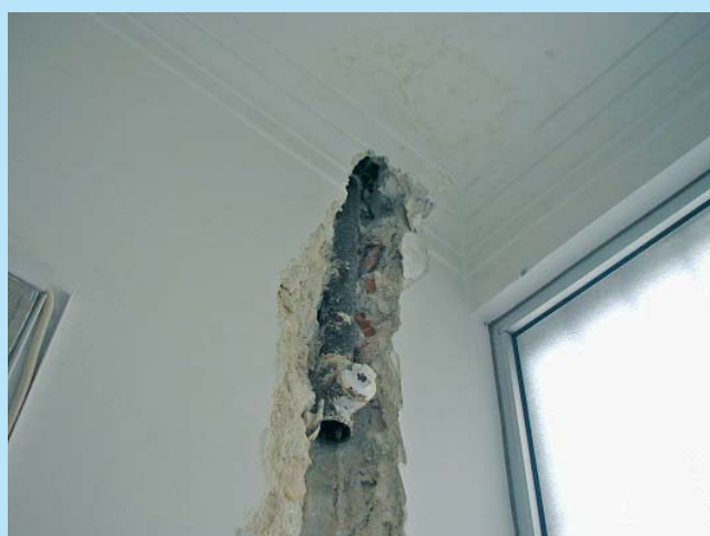
Foto 7: Infiltração de humidade. Dimensionamento inadequado das tubagens.
