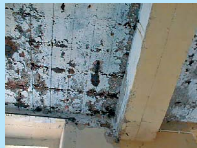
Foto 3: Corrosão das armaduras. Espessura de recobrimento insuficiente.
