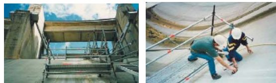
Figuras 1 e 2: Vista parcial do descarregador de cheias com as plataformas de acesso às zonas de ensaios e detecção de armaduras e medição do recobrimento com o pacómetro.
